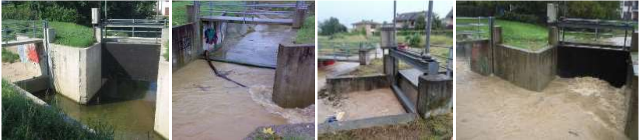
Figura 130 – Manufatto (4) di regolazione (partitore tra Torrente Trobbia e Scolmatore) in comune di Gessate.
