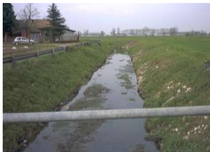
Figura 126 – Canale Sud Pedearginale in località Bolognina del comune di Pieve Porto Morone.
