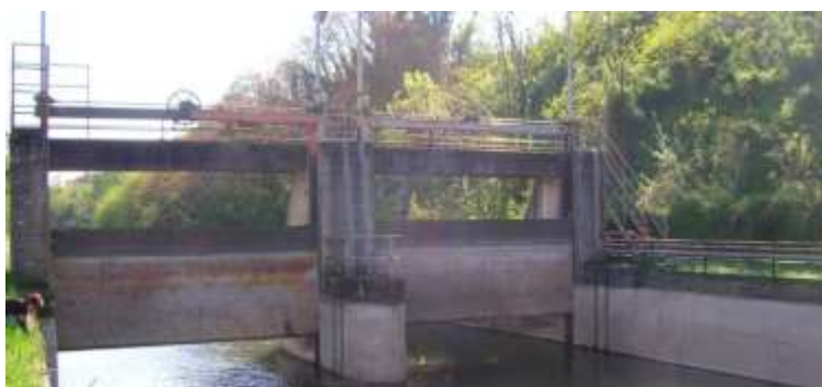
Figura 75 – Sbarramento di San Bartolomeo di regolazione delle portate irrigue del Naviglio Martesana.
