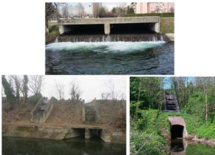
Figura 67 - Manufatto di sussidio da CAPV a Martesana a Cernusco SN (sopra); manufatto di sussidio da CAPV a Martesana (sotto a sinistra) e scarico in Adda a Gropello (sotto a destra).
