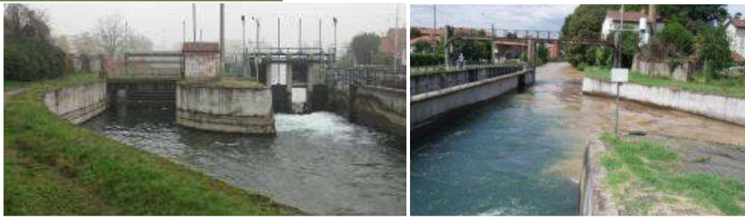
Figura 132 – Manufatto di regolazione a Villa Fornaci in comune di Bellinzago, con Scolmatore Trobbie (7) in destra idraulica delle paratoie di regolazione del Naviglio Martesana (5): vista da valle in magra (sinistra); vista da monte in piena con evidente diversa qualità/torbidità delle acque di Trobbie e Martesana (destra).
