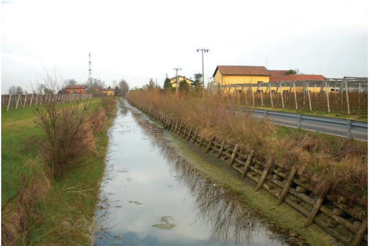
Fig. 4 – Palificata rinverdata nel periodo autunnale, dopo qualche anno dalla fine dei lavori (Fonte: Linee Guida Riqualificazione Canali, Regione Emilia Romagna)
